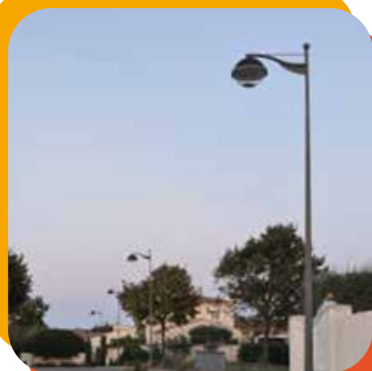
Éclairage : Mise en LED
